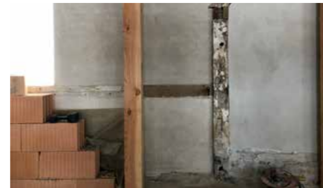
Isolering med teglblokke og træuld. Diffusionsåben facade
